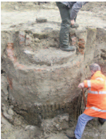
afbeelding 158, tijdens het vrijleggen van de recente waterput werd de gehele constructie met koepel (hier deels al afgebroken), betonringen, bakstenen schacht en houten stellatjes zichtbaar.
